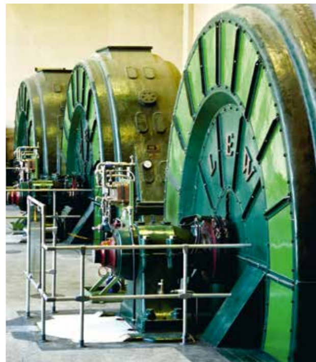
Maschinen von 1922, Kraftwerk in Meitingen
